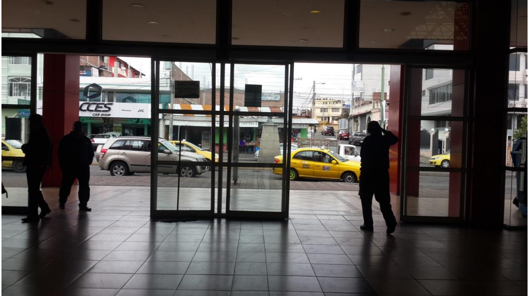
Infraestructura Interna dañada
