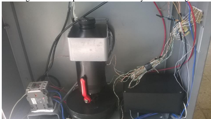
Figura 107. Tanques de alimentación y reserva de agua
