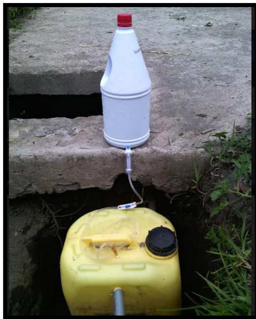
Figura 21.3 Estación de Dosificación y Mezcla del hipoclorito de sodio. Elaborado por: Victor Villacres, 2016
