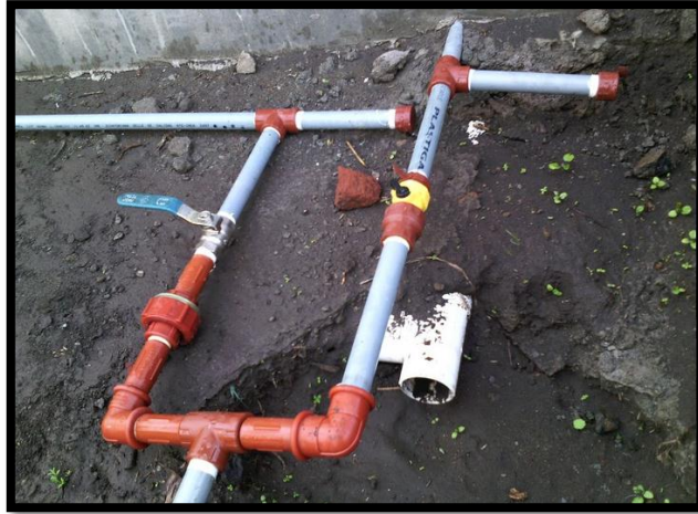
Figura 16.3 Vista lateral del sistema de drenaje con la tubería de dos pulgadas. Elaborado por: Victor Villacres, 2016
