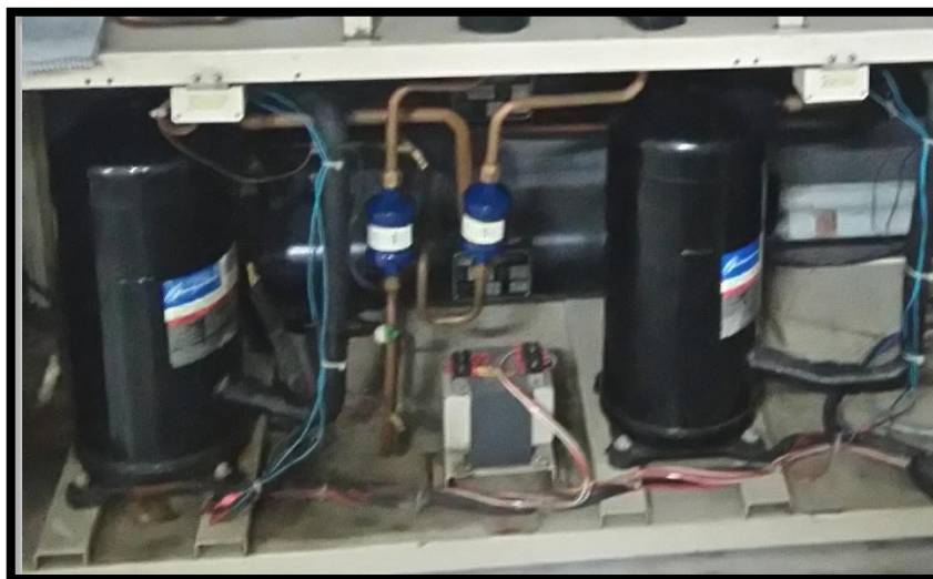
Figura 9-1 Compresores Copeland Realizado por: Gamboa. A. 2017.
