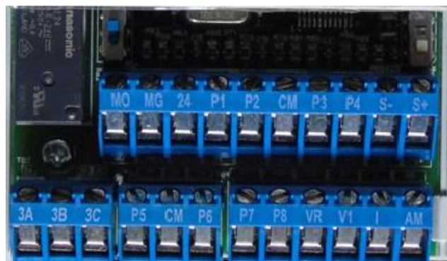
Figura 46 - 2 Bornes del Variador de Frecuencia
