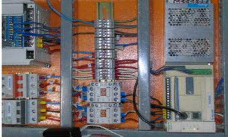
Figura 16 - 2 Conexión de los componentes eléctricos y electrónicos Realizado por: MOYOTA, Byron; GUILCAPI, Lidia, 2017
