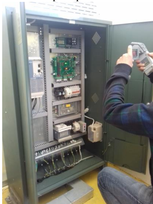
Figura 42. Tablero principal de control del ascensor
