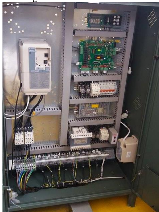
Figura 25. Tablero de control
