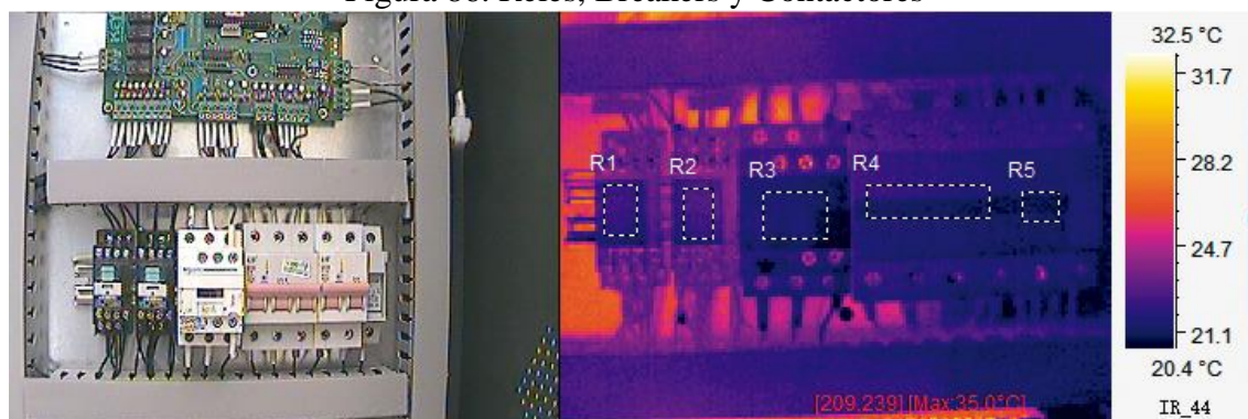
Figura 86. Relés, Breakers y Contactores
