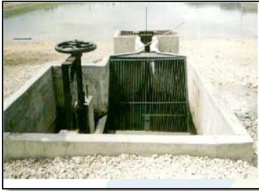
Figura 8-1: Rejillas de limpieza manual
