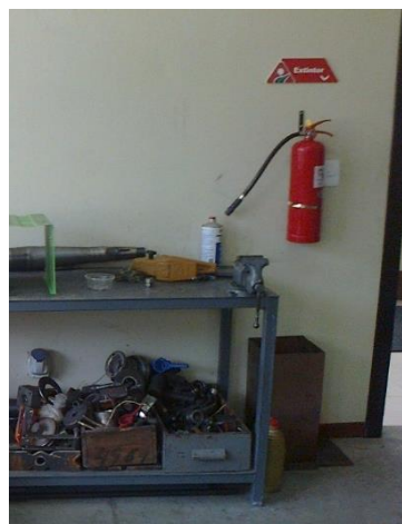
Figura 38. Extintor de fuego PQS. Fuente: Autor
