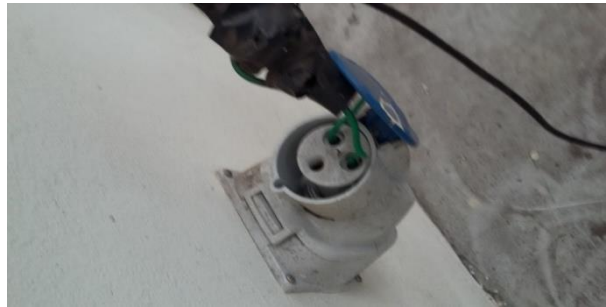
Figura 15. Toma de energía eléctrica en pésimas condiciones.
