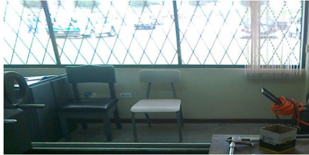
Figura 39. Ventanas sin acceso a ventilación. Fuente: Autor
