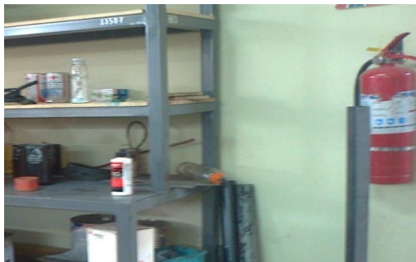
Figura 45. Extinto de PQS.
