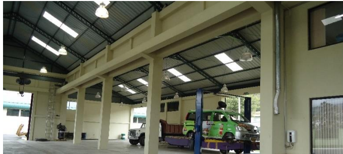
Figura 73. No existencia de señalética de seguridad vertical. Fuente: Autor
