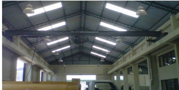
Figura 23. Área completamente ventilada. Fuente: Autor
