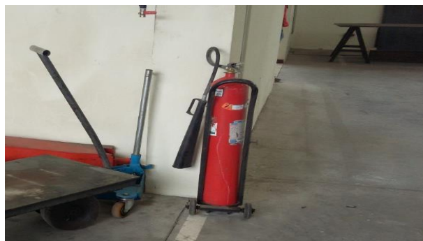
Figura 22. Extintor de fuego no ubicado correctamente.
