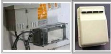
Figura II.19. Unidad de Acondicionamiento en cámara de transformación.
