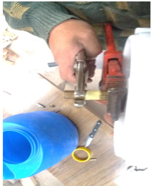
Fotografía 10 Unión entre el acople de la tapa y la salida a la manguera de gas
