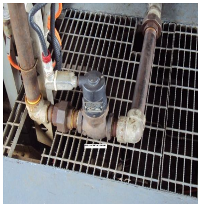
Figura 4-3. Válvula de corte gas Fuente: REPSOL Bloque 16. Elaborado por Cortez P. (2015)
