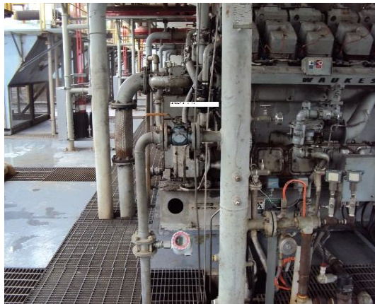
Figura 2-3. Filtro del sistema de gas Fuente: REPSOL Bloque 16. Elaborado por Cortez P. (2015)
