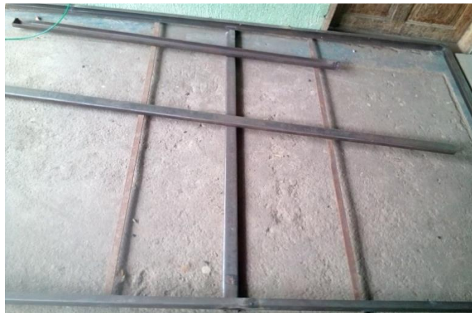
Figura 10-2 Construcción de la estructura para los paneles solares Fuente: LLAMUCA, Alex; CAISAGUANO, Alex, 2016
