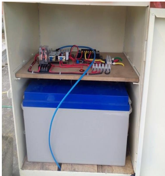
Figura 13-2 Caja eléctrica y tablero de control Fuente: LLAMUCA, Alex; CAISAGUANO, Alex, 2016
