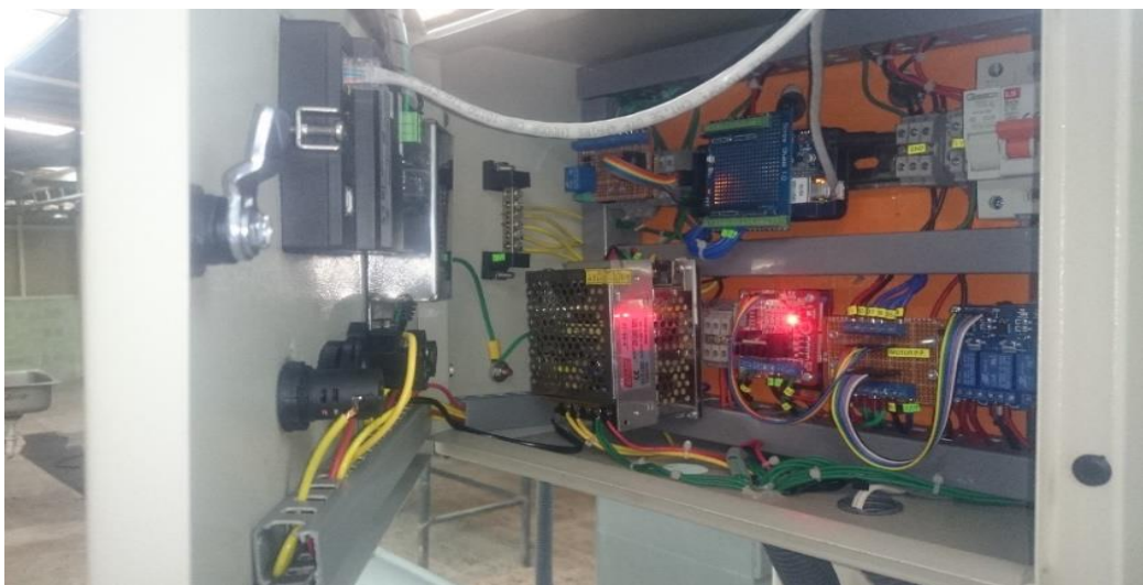
Figura 42-2 Interior del tablero de control Finalizado
