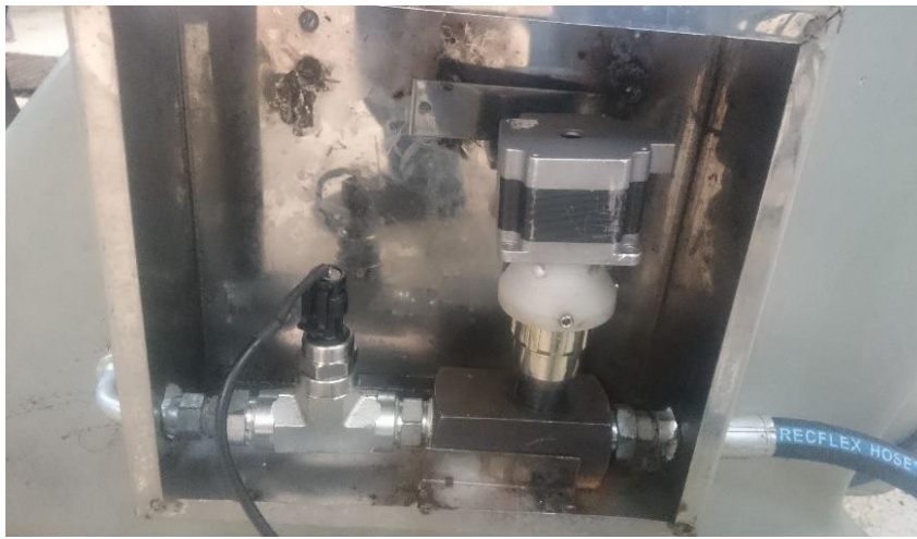
Figura 48-2 Implementación acople de la válvula y enroscamiento del sensor de presión
