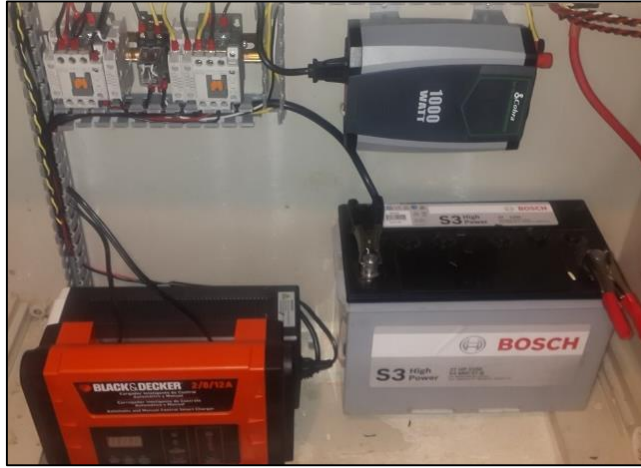
Figura 47-3: Tablero de transferencia automática Fuente: SILVA CONDE, Angel Alberto, 2016
