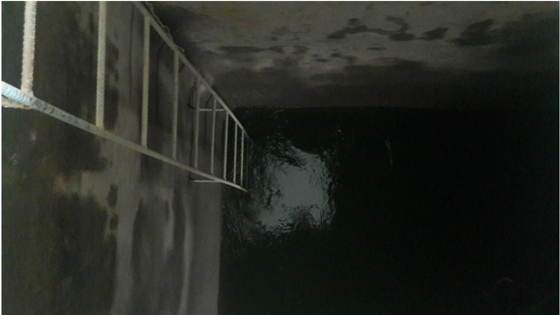
Tanque subterráneo para la toma del nivel
