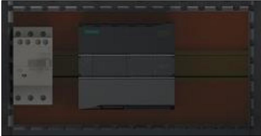
Figura 22-3: Montaje del PLC S7 1200 Fuente: SILVA CONDE, Angel Alberto, 2016
