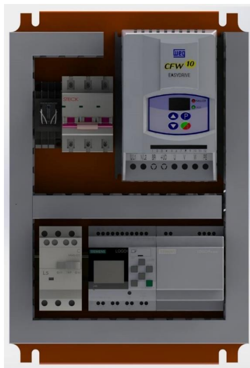
Figura 30-3: Tablero de control para el ingreso de agua Fuente: SILVA CONDE, Angel Alberto, 2016
