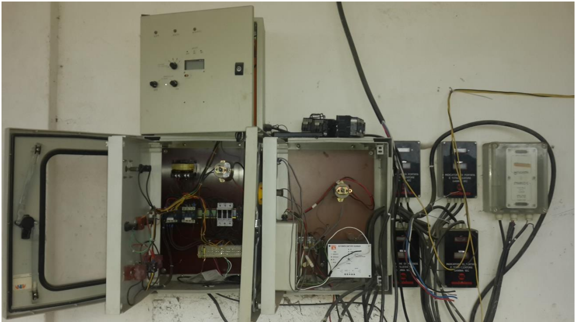
Sistema de control obsoleto
