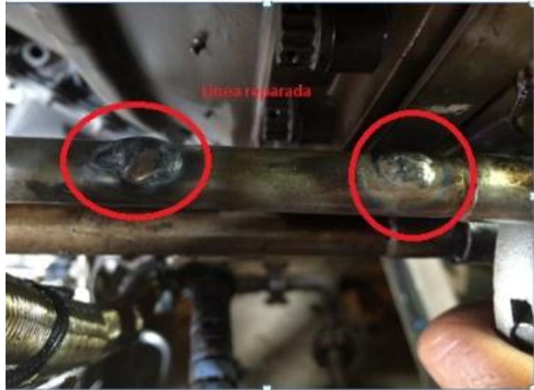
Figura 22.3. Cañería con fuga de aceite turbina A.
