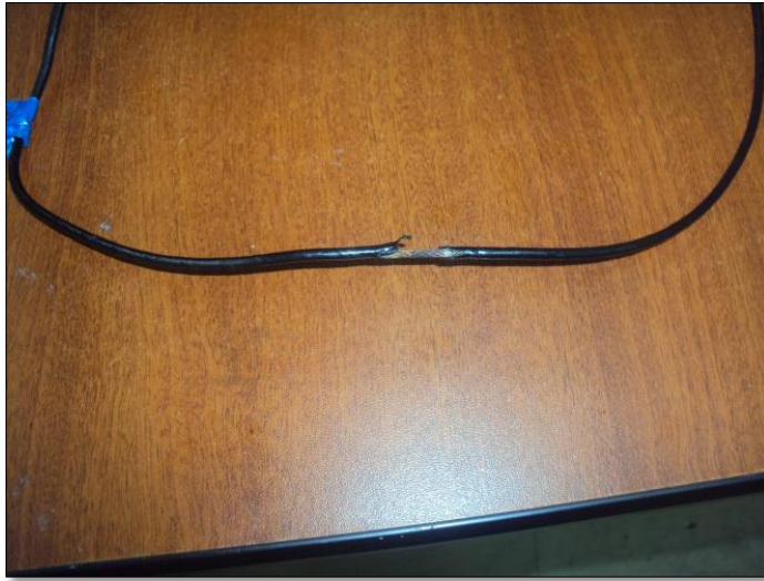
Figura 4.3. Cable pelado en turbina
