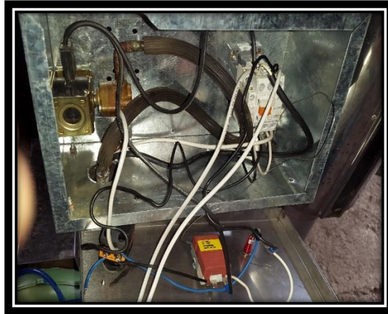
Figura 2-3 Antiguo tablero de control del secador por lecho fluidizado. Realizado por: Arévalo V. y Anguisaca L. 2016.
