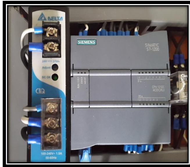
Figura 13-3 PLC Siemens S7 1200. Realizado por: Arévalo V. y Anguisaca L. 2016.
