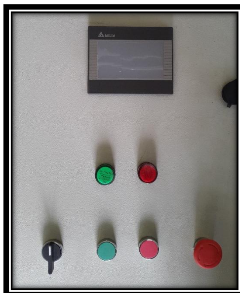
Figura 9-3 Nuevo tablero de control vista externa. Realizado por: Arévalo V. y Anguisaca L. 2016.
