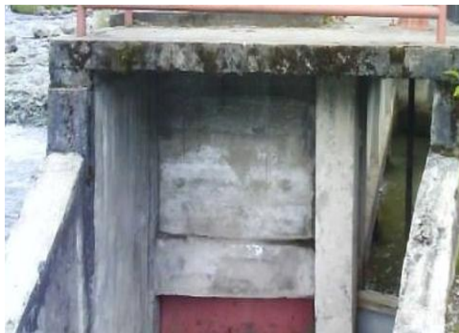
Figura 9. Compuertas para desarenado
