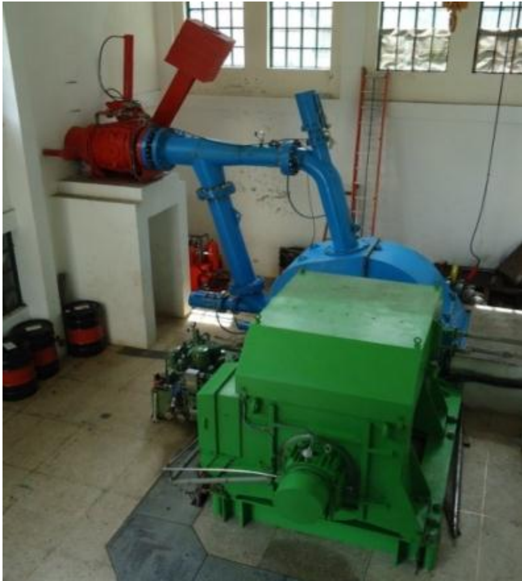
Figura 13. Cuarto de Máquinas de la Central Rio Blanco
