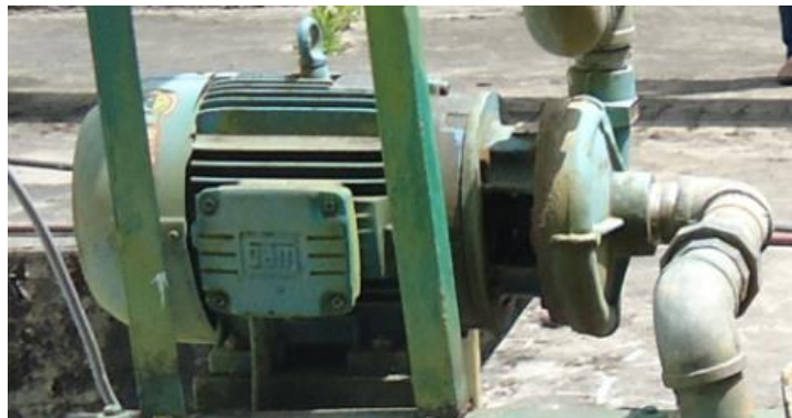
Figura 24. Bomba emergente del sistema de enfriamiento por agua
