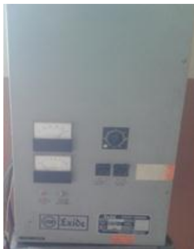
Figura 37. Cargador de Baterías (Rectificador)
