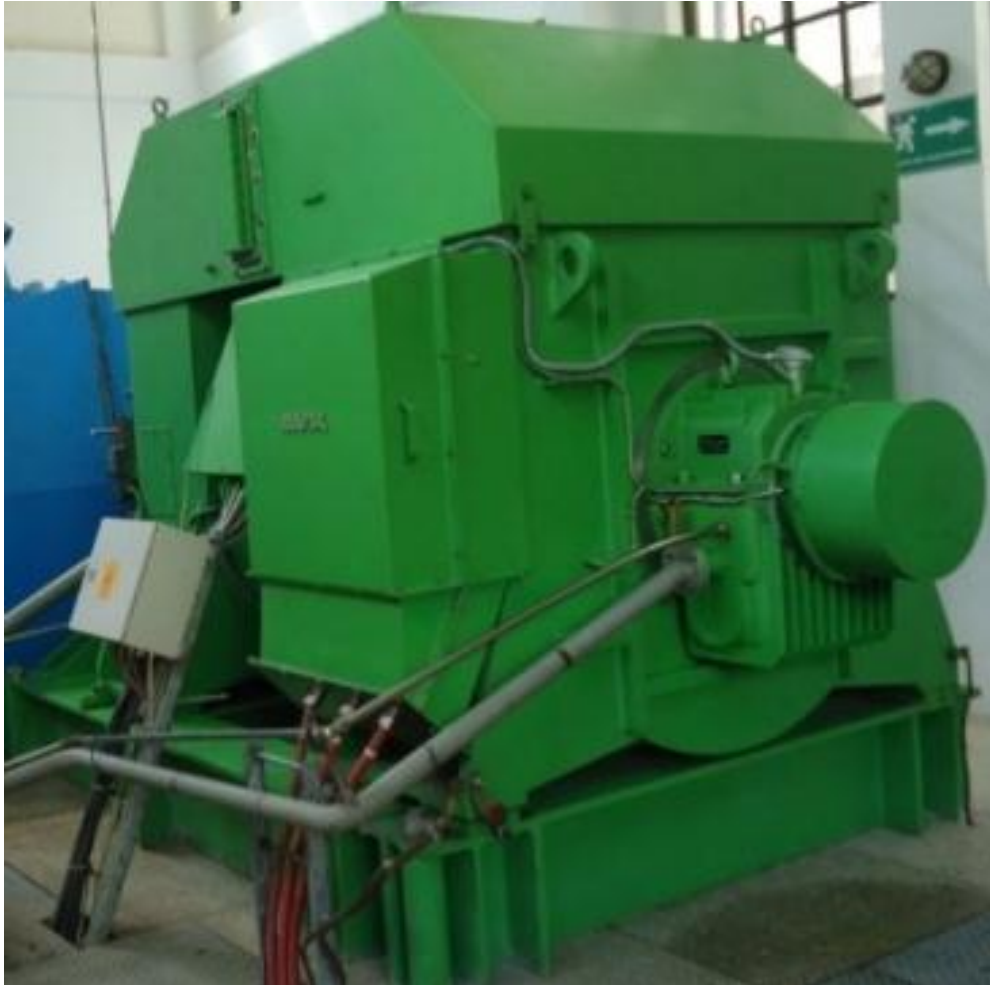
Figura 17. Generador Eléctrico Marca AVK
