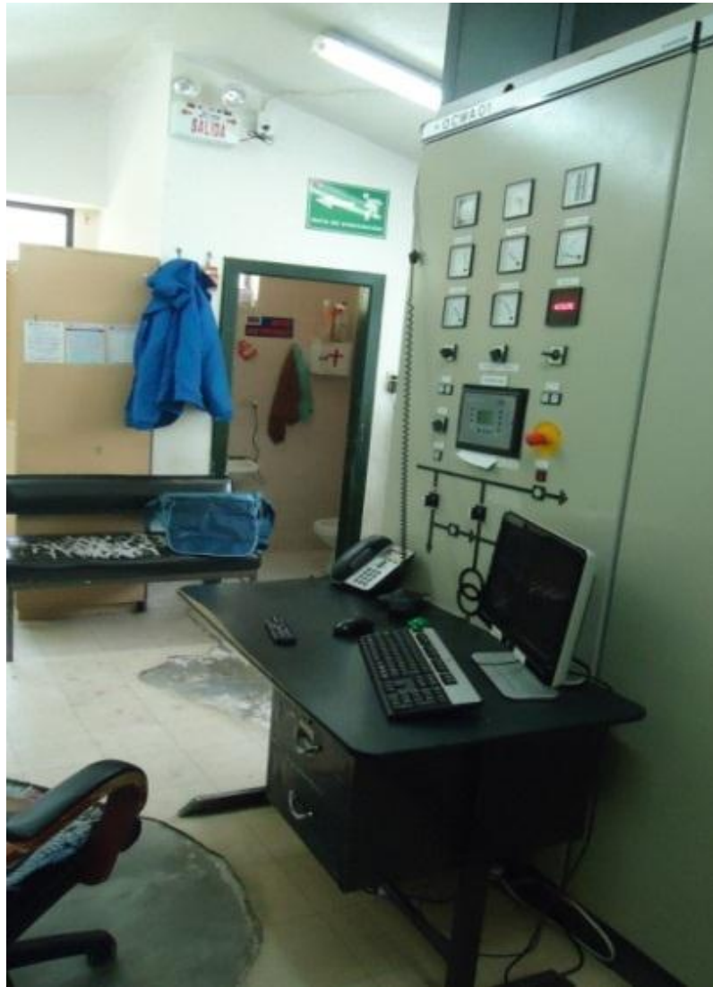
Figura 26. Sala de Control
