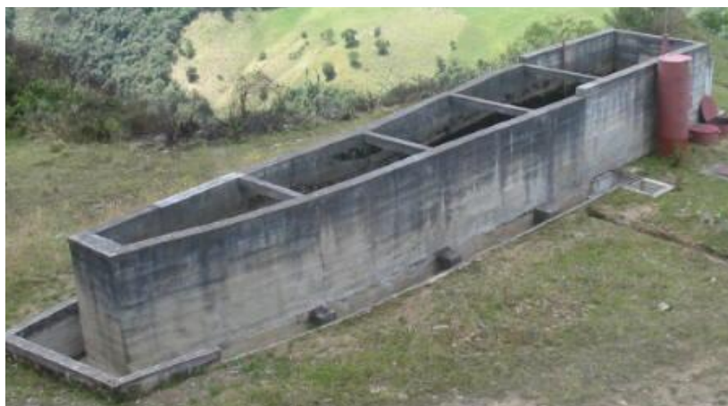
Figura 11. Tanque de Presión de la Central Río Blanco
