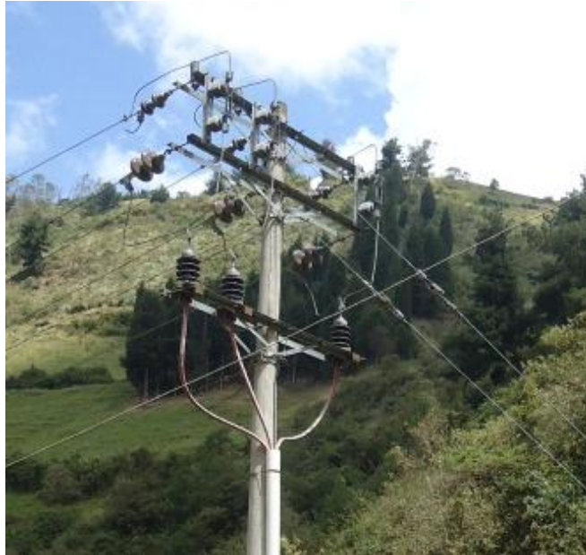
Figura 34. Seccionadores de Cuchillas
