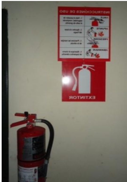
Figura 38. Equipo contra incendios
