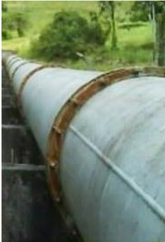
Figura 12. Tubería de Presión
