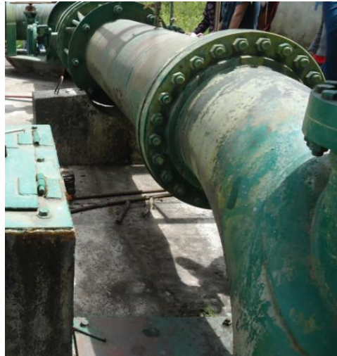
Figura 23. Sistema de bypass de la tubería principal
