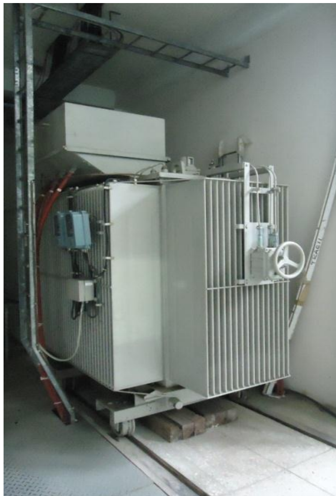
Figura 32. Transformador de potencia de la Central Río Blanco
