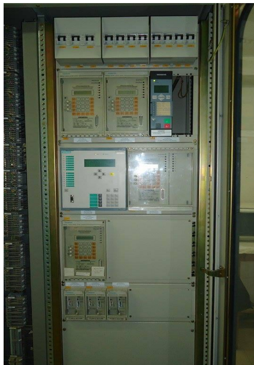
Figura 29. Sistema de Relés de Protección
