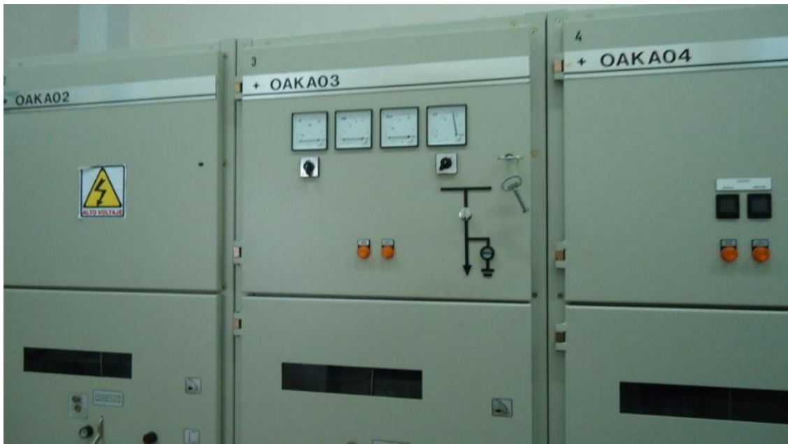
Figura 33. Interruptor automático extraíble de la central Rio Blanco
