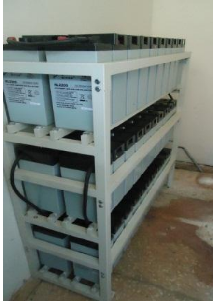
Figura 36. Banco de baterías de la Central Hidroeléctrica Rio Blanco
