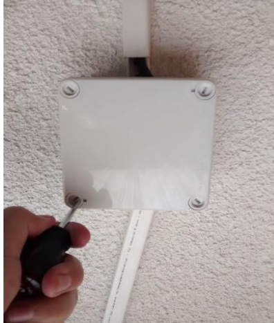
Figura 68. Caja de Derivación
