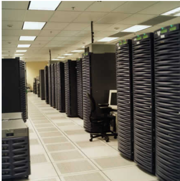
Figura II.5: Fotografía del centro de datos de Google (USA).
