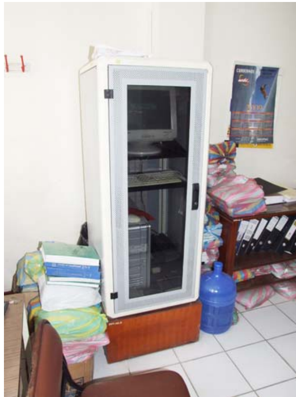
Servidor de Contabilidad (Fuera del centro De datos)
