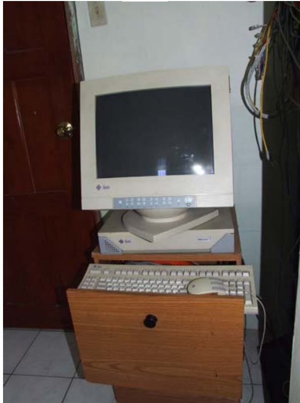
Antiguo Servidor De facturación
