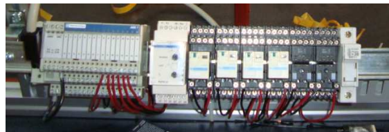
Figura. IV.27. Modulo de control del sistema de mezclado de líquidos
