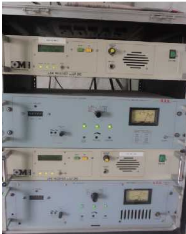
Conjunto de equipos transmisores y receptores de microonda
