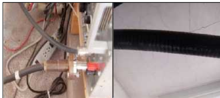
Figura 3-2.- Conectores (izquierda) y cable coaxial (derecha)
