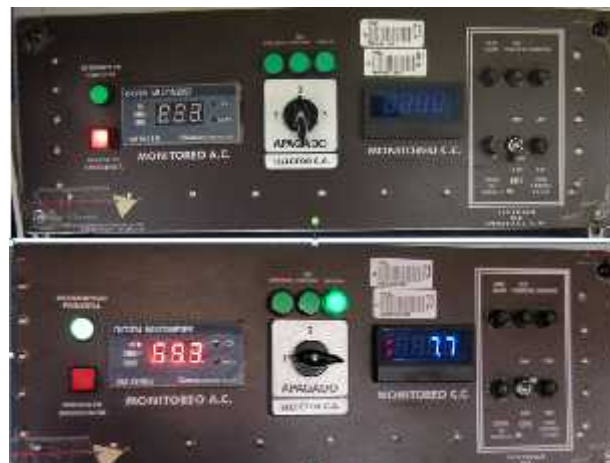
Figura 34-1.- Sistema de protección de potencia DIAF, apagado (arriba) y en funcionamiento (abajo)
