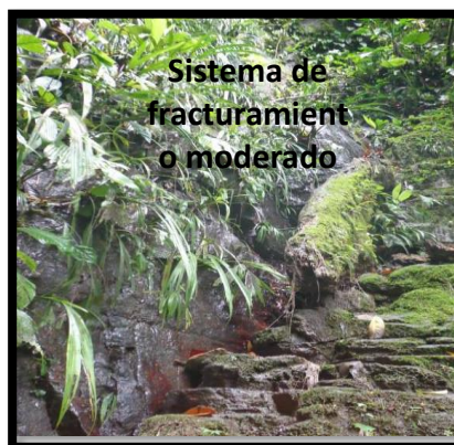
Fotografía 9-3: Falla con aumento en la intensidad de fracturas
