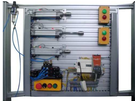
Figura IV. 36 Salida del Cilindro B+ en el tablero de aluminio
