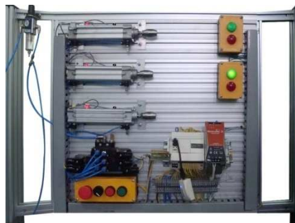
Figura IV. 40 Foco Verde2 encendido en el tablero de aluminio
