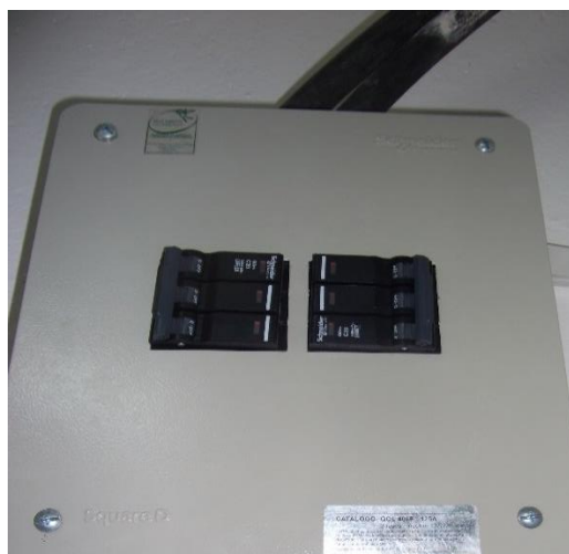
Fotografía 11. Breakes para el control del sistema eléctrico.
