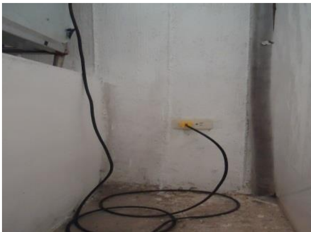
Fotografía 12. Conexiones eléctricas la Unidad Académica de Investigación y Producción Avícola en la Facultad de Ciencias Pecuarias.
