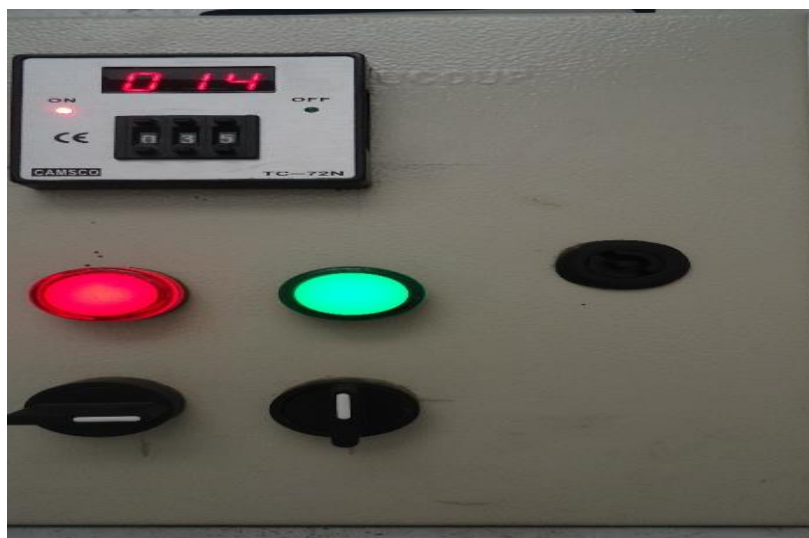
Fotografía 3. Control de temperatura.
