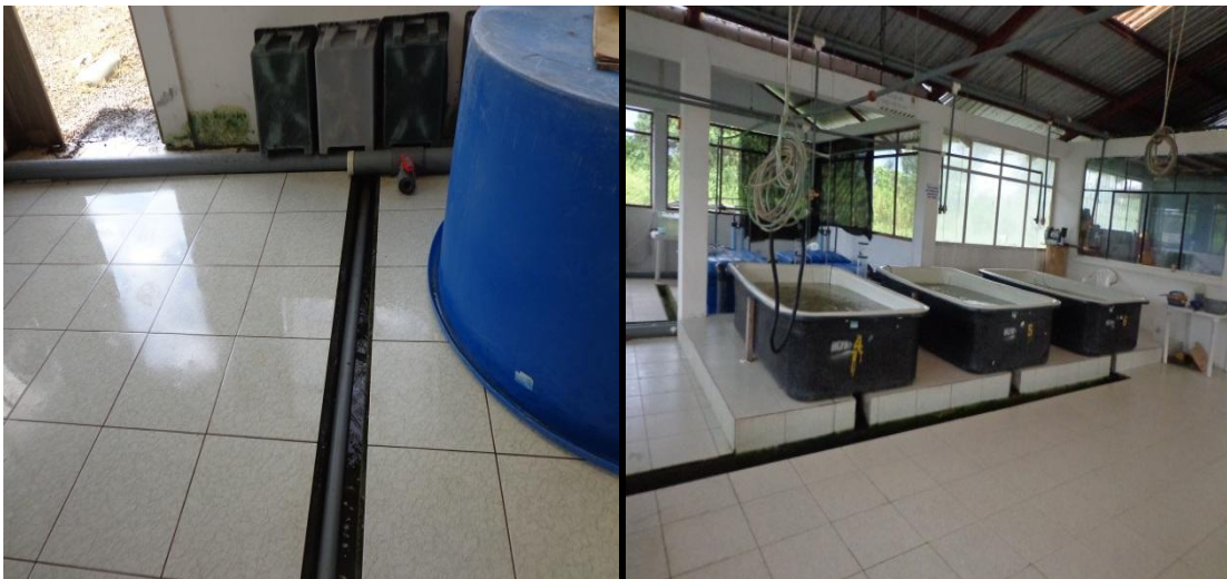
Fotografía 5. Drenaje y acumulación de las aguas residuales.
