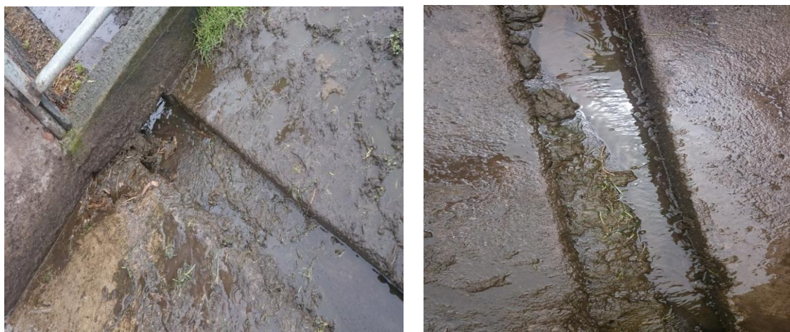
Fotografía 4. Drenaje y acumulación de las aguas residuales.
