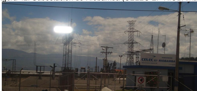
Figura 42. Subestación de Riobamba (CELEC EP RIOBAMBA)
