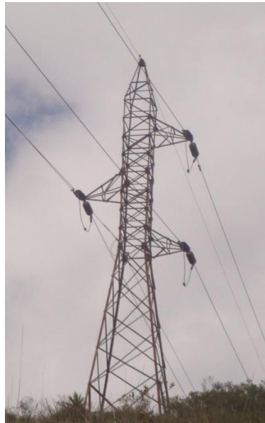
Figura 37. Torre o estructura de transmisión
