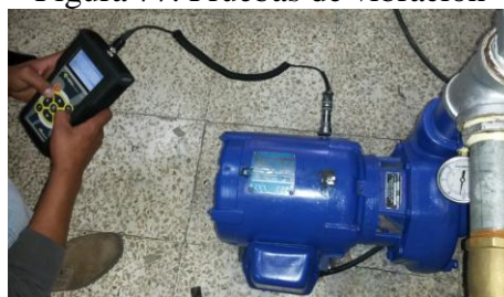
Figura 77. Pruebas de vibración
