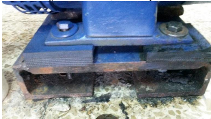
Figura 26. Bomba, cauchos y base
