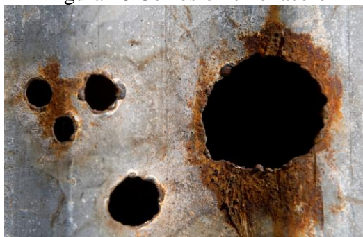
Figura 18 Corrosión en el acero
