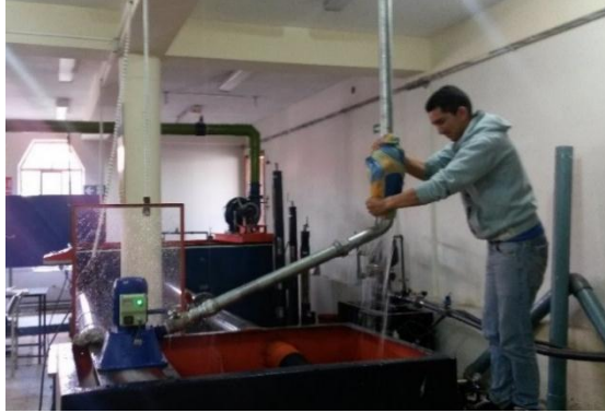
Figura 34. Fuga en el accesorio especial.
