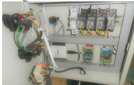
Figura 65. Tablero de control
