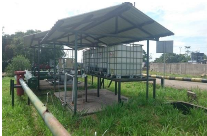
Figura 2-3. Tanque de almacenamiento de químico.
