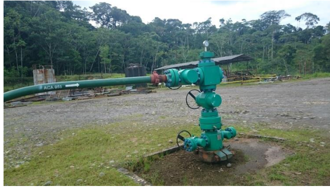
Figura 11-3. Pozo reinyector de agua RW-55
