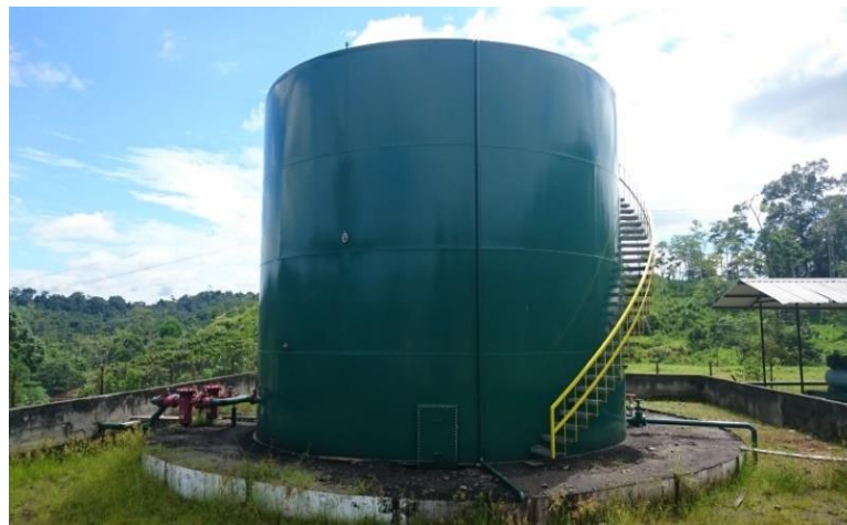
Figura 5-3. Tanque de almacenamiento de agua de formación.
