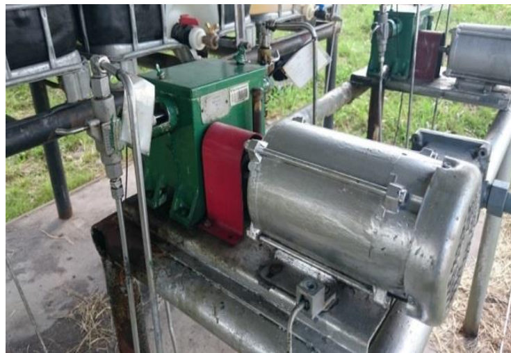
Figura 3-3. Bomba para inyección de químicos.
