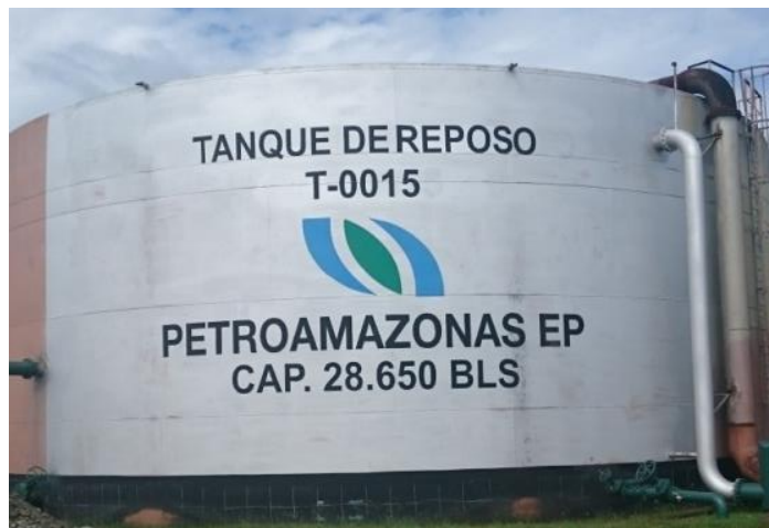
Figura 1-3. Tanque de reposo.
