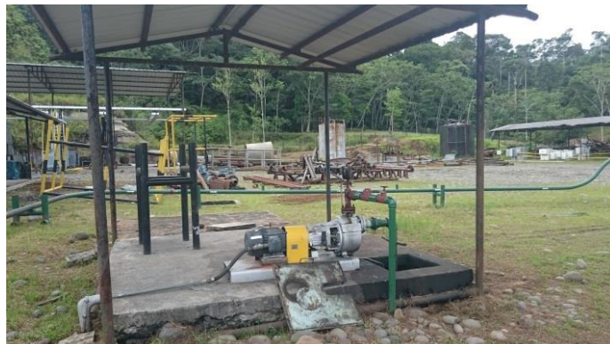
Figura 10-3. Bomba del sumidero.
