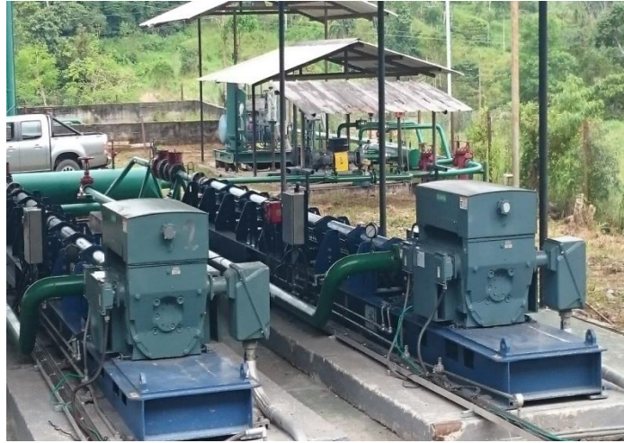
Figura 9-3. Unidades de reinyección de agua HPS.
