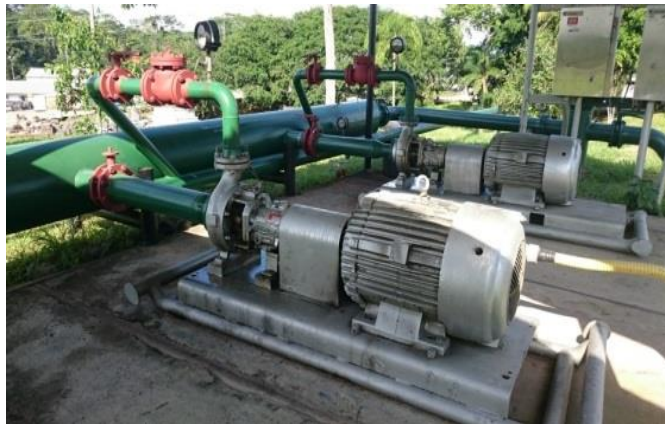
Figura 4-3. Unidades centrífugas de transferencia.
