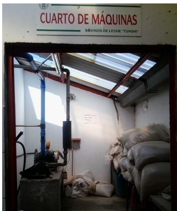
Figura 7 - 4. Cuarto de Máquinas
