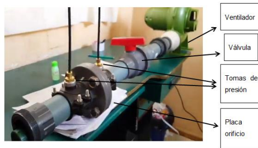
Figura 70. Forma de instalación de la placa orificio para medición de caudal.
