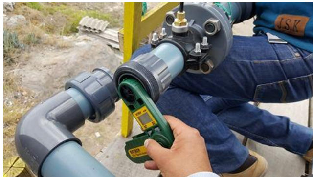
Figura 61. Verificación de funcionamiento de los medidores de caudal.
