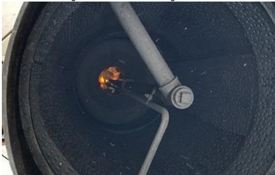
Figura 58. Encendido del gasificador.
