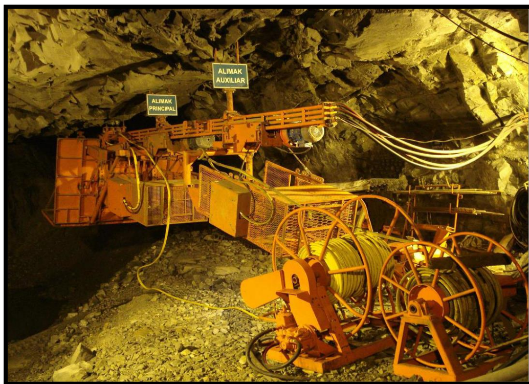
Fotografía 7. Plataforma Trepadora Alimak, modelo STH-5E
