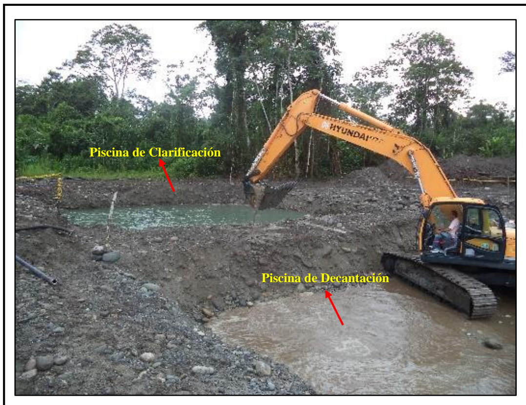
Fotografía 17. Piscinas de Decantación y Clarificación
