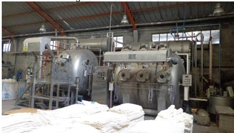
Figura 4. Área de tintorería
