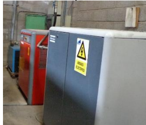
Figura 19. Compresores de aire
