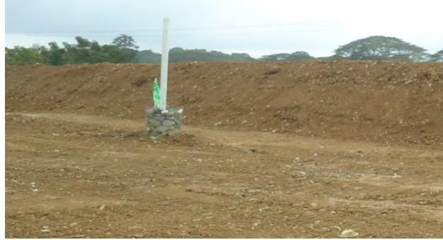
Figura 24-1. Respirador de gas del Relleno Sanitario del Cantón Salcedo Fuente: JÁCOME, David. 2015
