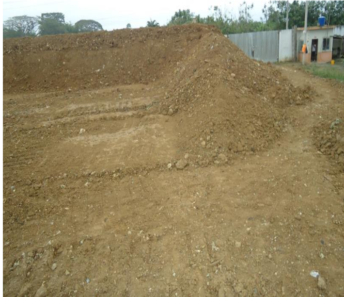
Figura 25-1. Llenado del Relleno Sanitario Fuente: JÁCOME, David. 2015
