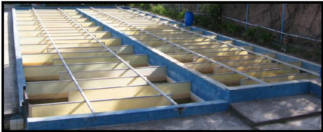
Figura 10. Floculador hidráulico de flujo horizontal.
