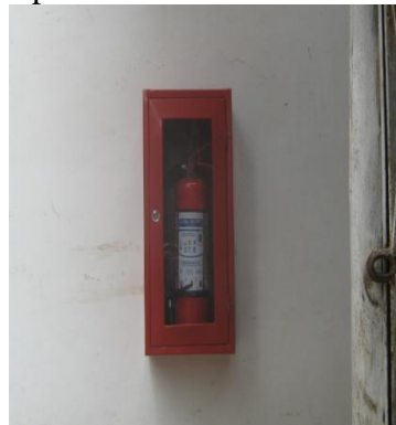
Figura 54. Implementación de extintores y gabinete
