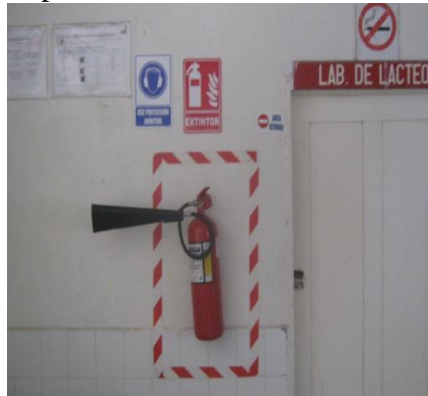
Figura 52. Implementación de extintores de 10 lb. CO 2
