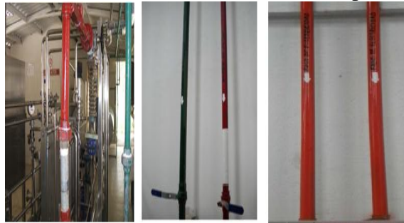
Figura 48. Señalización de tubería áreas de producción
