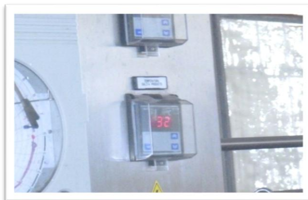
Figura 19. Calibración de temperatura de pasteurizador
