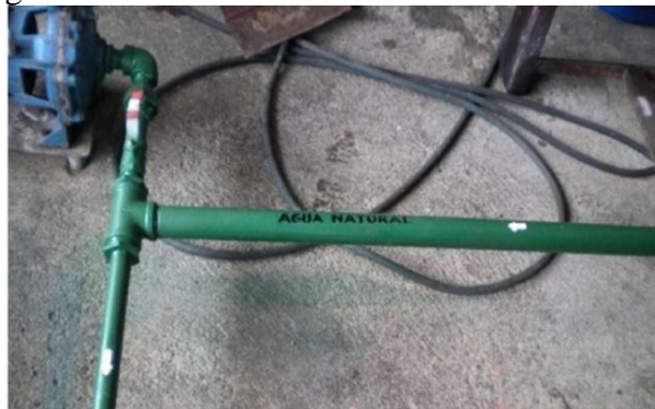
Figura 49. Señalización de tuberías área de calderos
