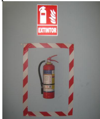
Figura 53. Implementación de extintores de 10 lb PQS
