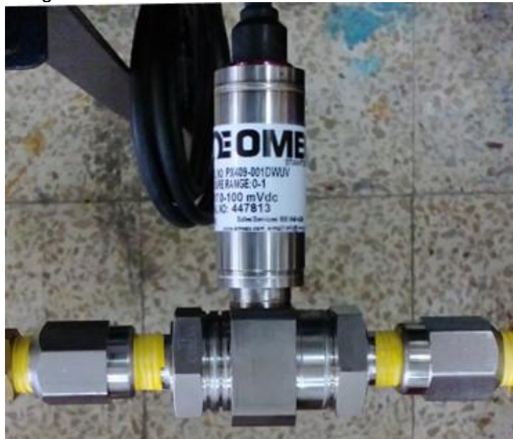
Figura 64. Instalación del sensor PX409-001DWUV
