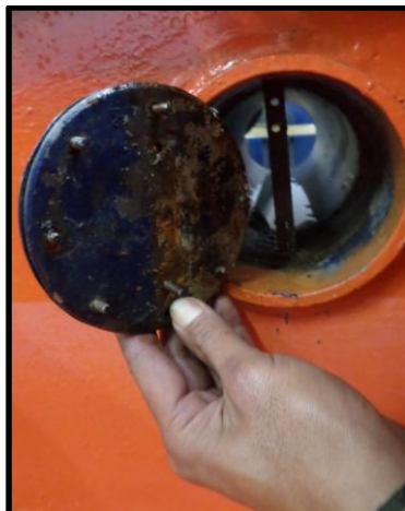
Figura 26. Estado anterior de la válvula de mariposa
