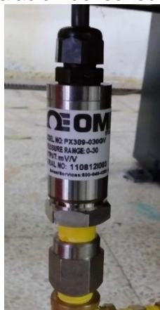
Figura 60. Instalación del sensor PX309-030GV
