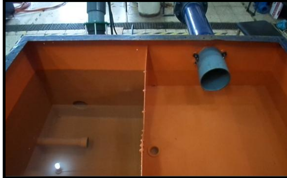
Figura 30. Estado actual del tanque
