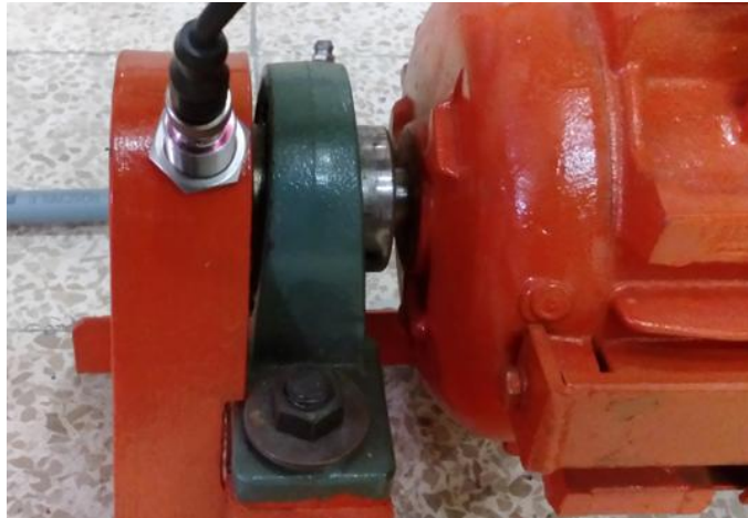
Figura 65. Instalación del sensor inductivo M18 PNP Bi8U-EM 18-AP6X-H1141
