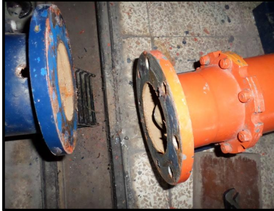
Figura 25. Conexión bridada entre el tanque y la bomba axial
