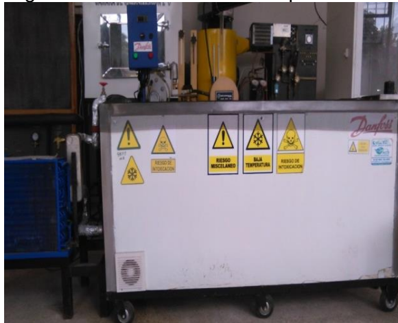
Figura 37. Chiller antes de la repotenciación
