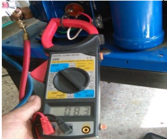
Figura 39. Medición de corriente al arranque
