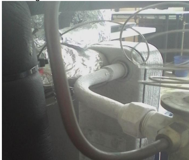
Figura 70. Congelamiento inicial del intercambiador de calor
