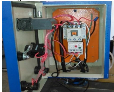
Figura 52. Tablero de control
