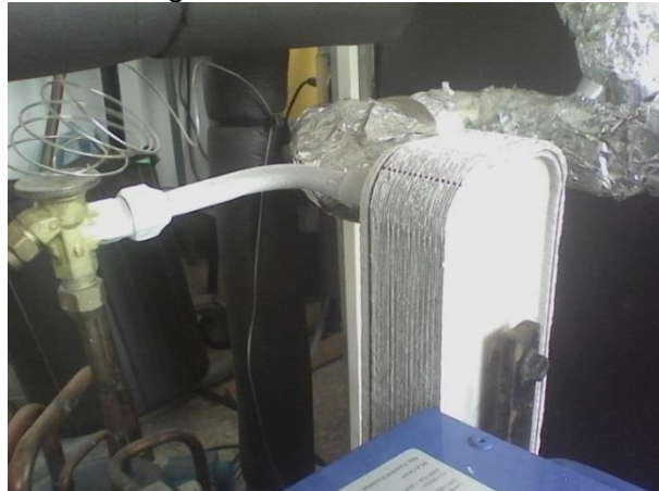
Figura 71. Congelamiento del intercambiador de calor
