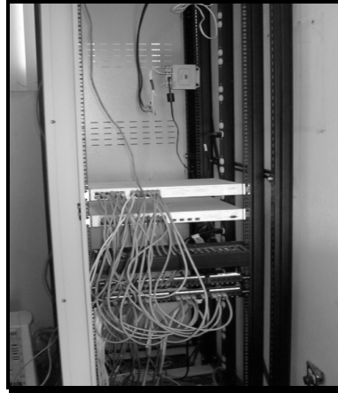
Fig. II.16. Infraestructura tecnológica de la EIS.
