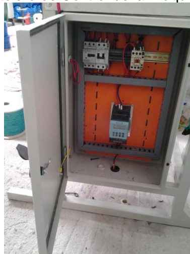
Figura 14. Tablero de Control de la máquina bobinadora
