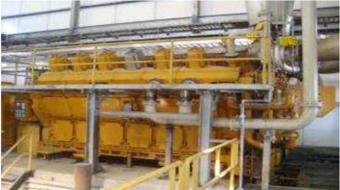
Figura 1-3 Grupo Electrónico MG1 - 5380 kW, 13.8 kV. Fuente: (Petroamazonas EP - AMS, 2013, p. 7)
