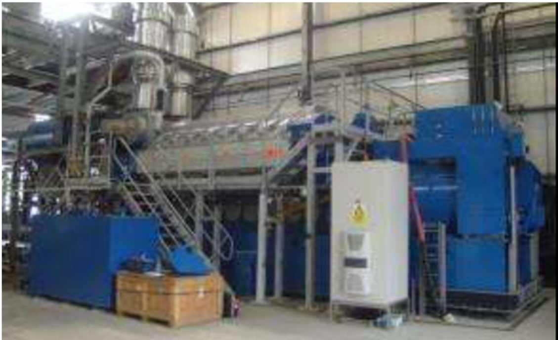
Figura 2-3 Grupo Electrónico MG2 - 6850 kW, 13.8 kV. Fuente: (Petroamazonas EP - AMS, 2013, p. 7)
