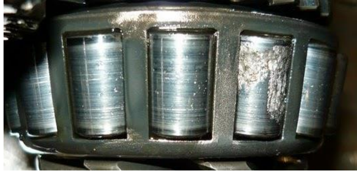
Figura 19. Degradación del rodamiento con desprendimiento de material.
