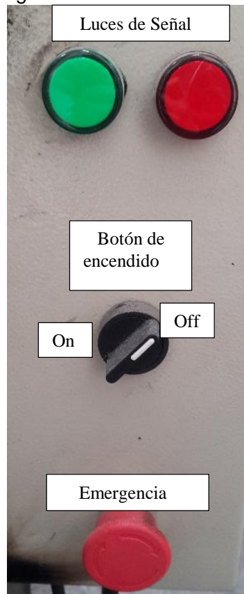
Figura 65: Tablero de control
