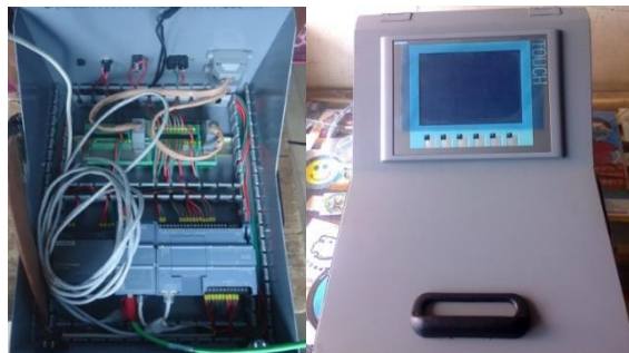
Figura 98. Módulo de control
