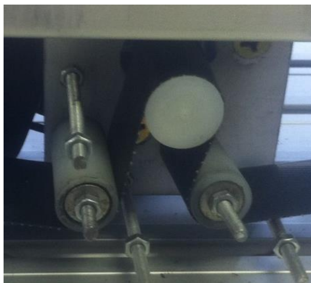
Figura 58.2. Banda transportadora montaje
