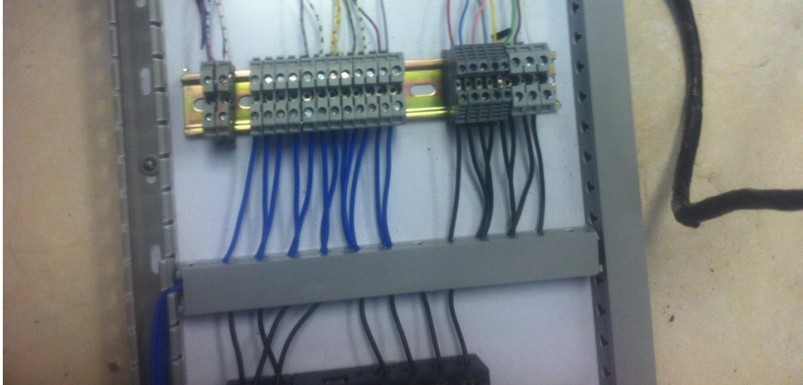
Figura 64-2. Cableado tablero PLC
