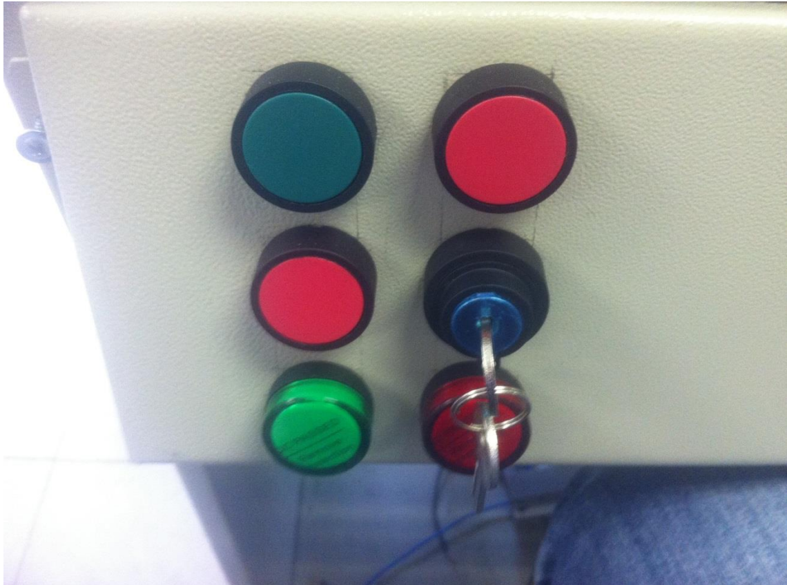
Figura 61.2. Módulo de distribución pulsadores
