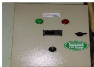
Figura 4. Tablero de control del cuarto frío
