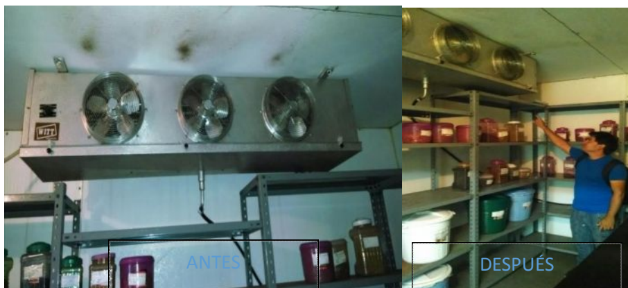
Figura 10. Condiciones del evaporador
