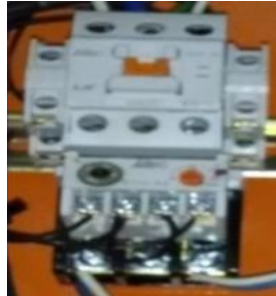
Figura 5. Contactor del tablero
