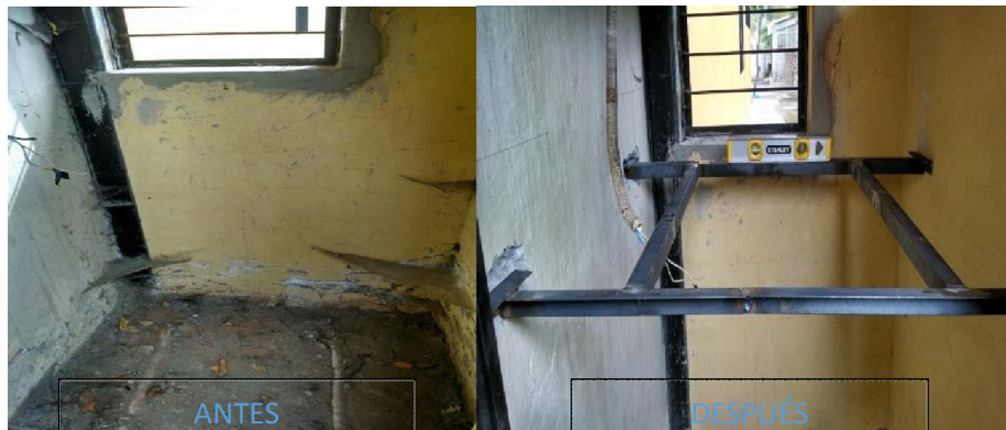
Figura 8. Lugar de ubicación de la unidad condensadora
