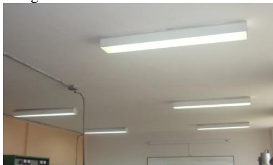
Figura 14. Iluminación del laboratorio
