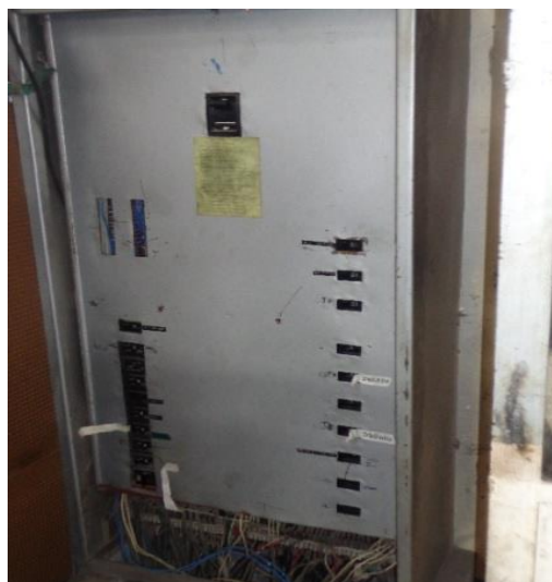
Figura 28. Tableros de Protección
