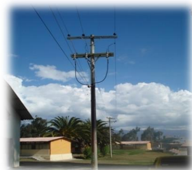
Figura 25. Línea de MT 13.8 kV
