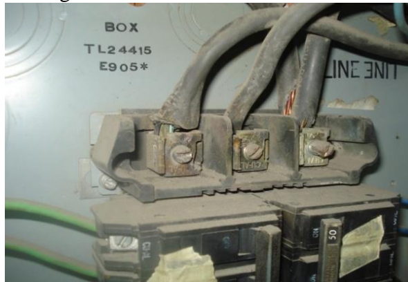
Figura 5. Contactos con sulfatamiento
