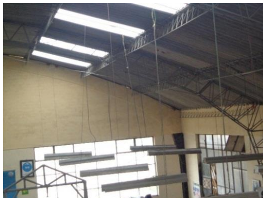
Figura 6. Iluminarias del Taller de Mecanizado Básico
