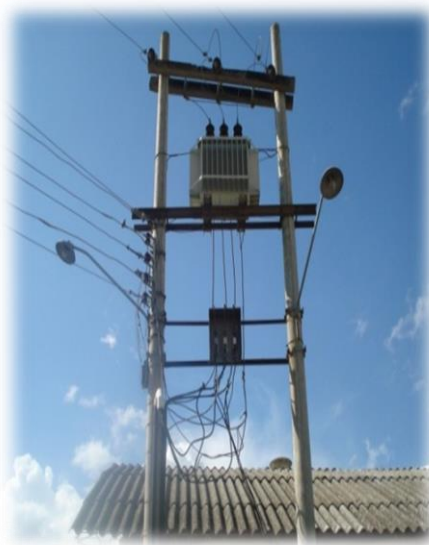
Figura 27. Transformadores trifásicos de 100 kVA.
