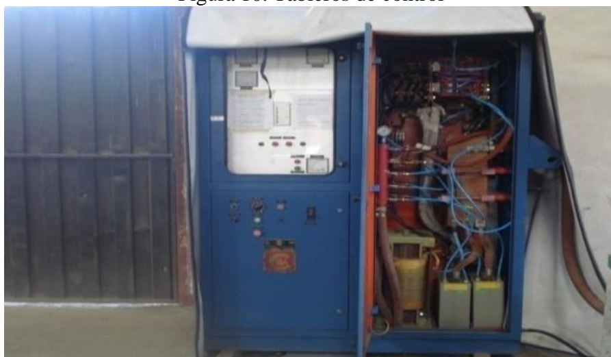
Figura 10. Tableros de control
