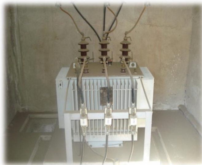
Figura 24. Transformador del Taller de Fundición
