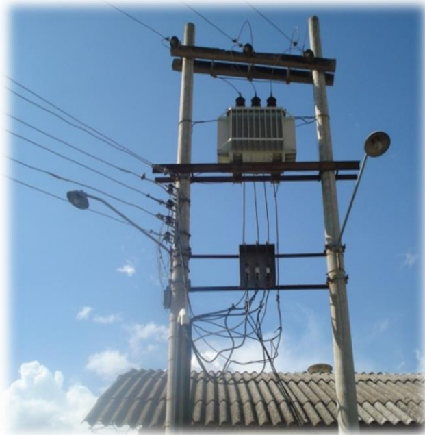
Figura 23. Transformador del Taller de Mecanizado Básico y Soldadura
