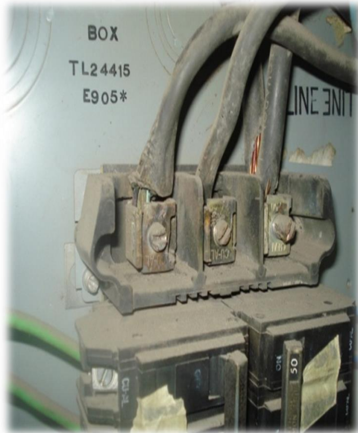
Figura 29. Sobrecalentamiento de conductores
