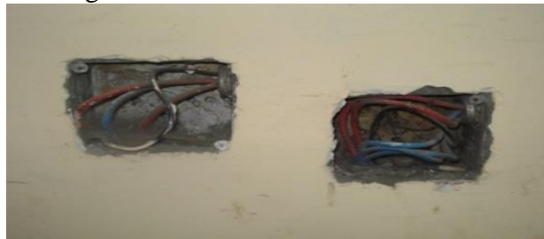
Figura 11. Instalaciones en mal estado
