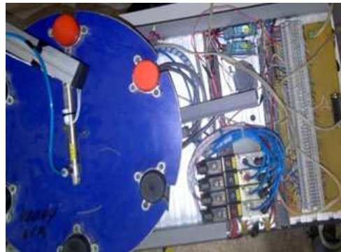
Figura 22. Estación de Verificación en mal estado
